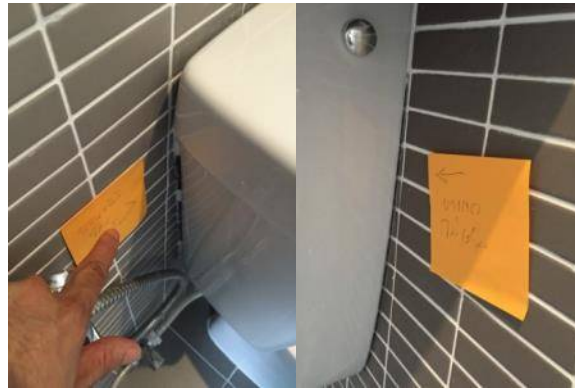
7.ยาแนวซิลิโคนไม่เต็ม
