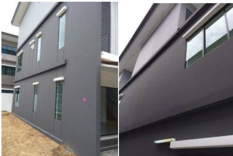
ทาสีผนังภายนอกใหม่ทั้งหมด มีรอยต่างและรอยแตกร้าว
