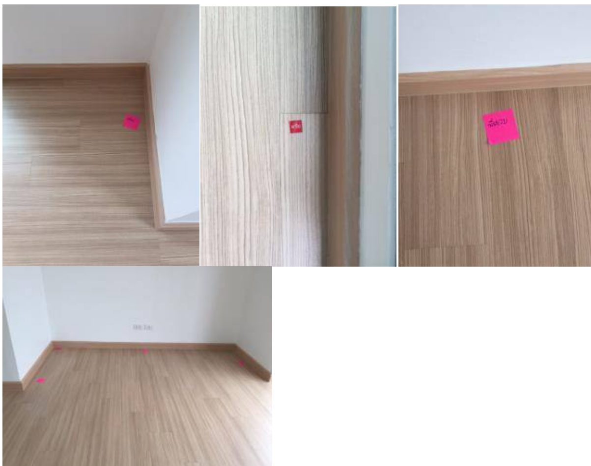
2. พื้นเสียงดัง+เช็คพื้นยวบรอบห้อง+พื้นลามิเนตห่าง+พื้นลามิเนตแตก+ทำความสะอาดพื้น
