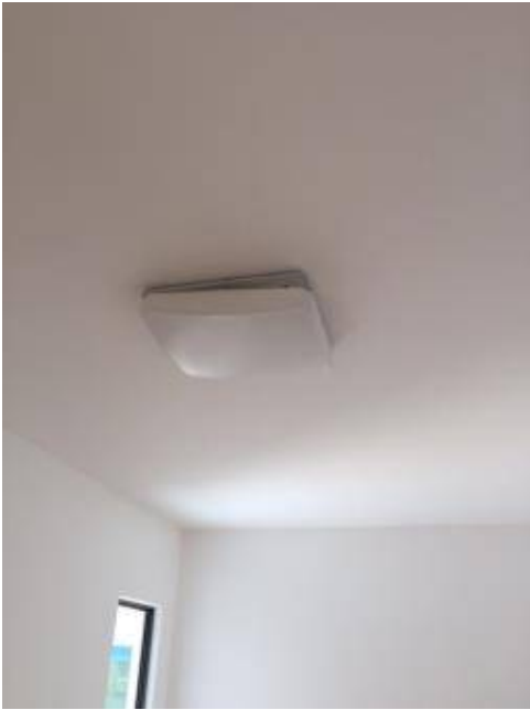
2. ติดโคมไฟไม่เรียบร้อย+ทำความสะอาด
