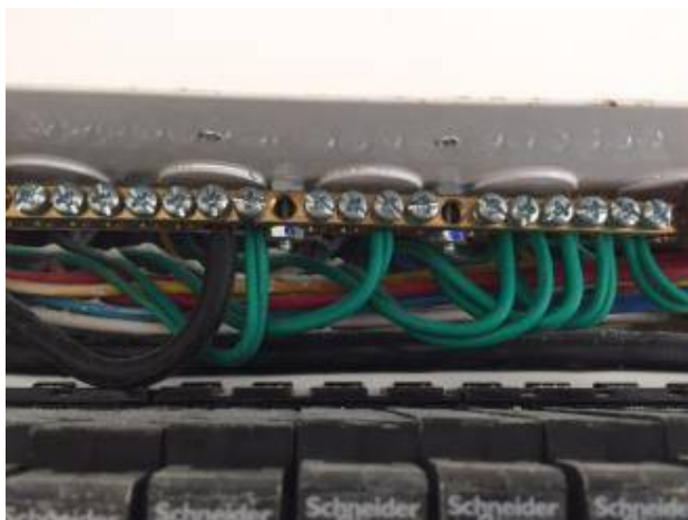
แยกสายดินออกจากกันไม่ได้ รวมกัน สายหนึ่งเส้น น๊อตหนึ่งตัว
