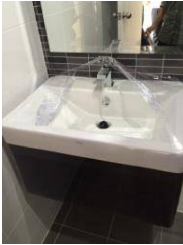
3. ก๊อกน้ำไหลไม่แรง เช็ควาล์ว *หมายเหตุไม่มีปั๊มน้ำ
